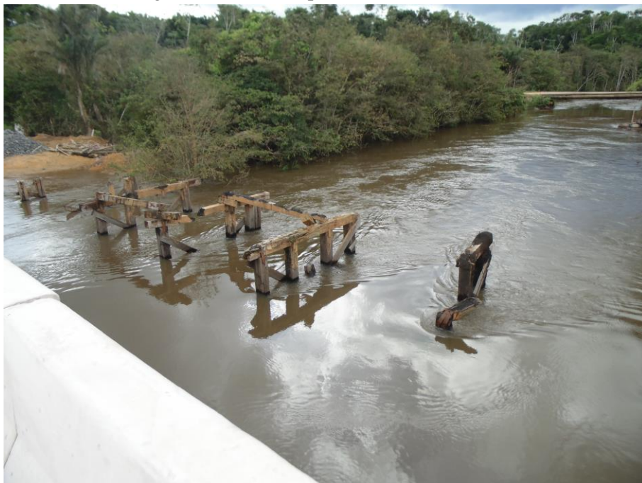
Figura 2. Ponte Colapsada sobre o Rio Belém
