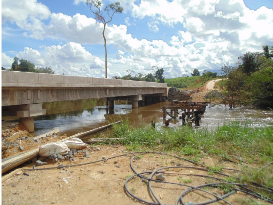
Figura 1. Ponte colapsada sobre o Rio Belém
