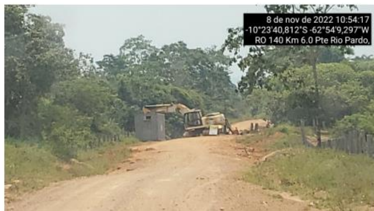
Foto 1 – Container, da contratada e ausência da Placa de obra.
