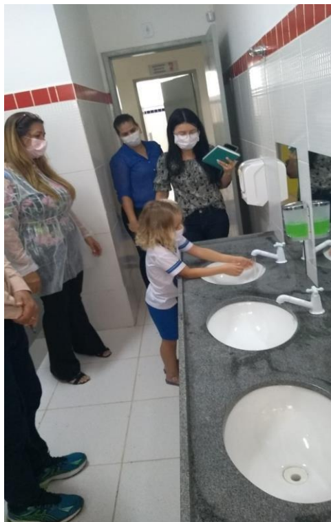
Distância das maçanetas das torneiras e saboneteira inadequada para crianças abaixo de 5 anos idade.
