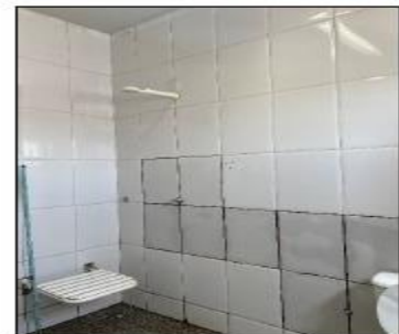
Figura 51 – banheiro enfermaria D
