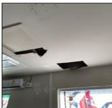
Figura 15 – Forro da enfermaria D
