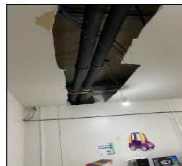
Figura 26 – Esponjoso substituído da sala dos médicos do 2º andar.
