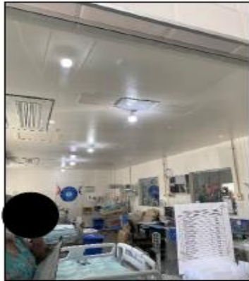
Figura 17 – Forro de gesso os leitos de UTI
